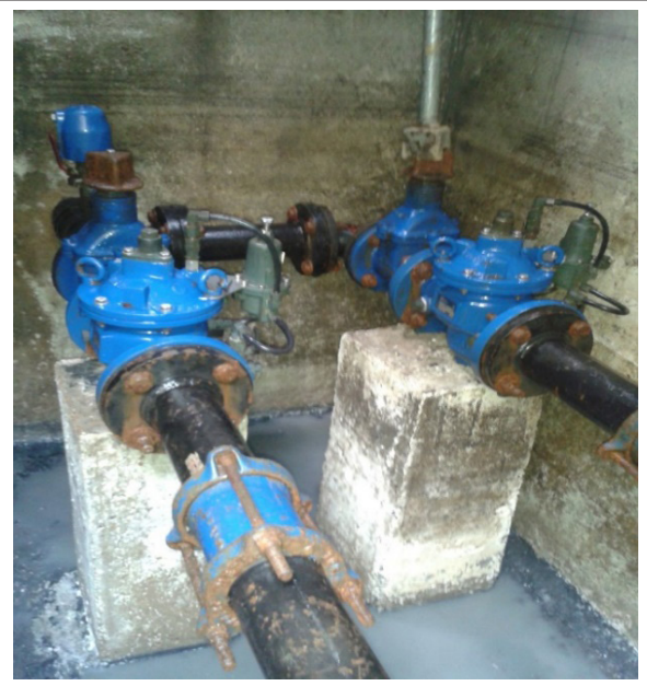
Figura 2. Estación reguladora de presión ubicada en la Zona 1, EAB.
